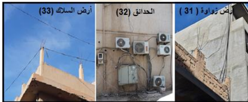
المصدر : الدراسة الميدانية 2020/3/15 الصور ( 33 - 32 - 31 )
